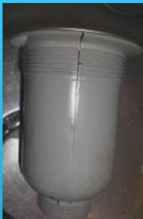
排水トラップ割れ
